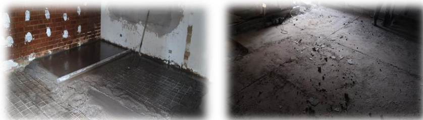
FIGURA 35 CUARTO DE REFRIGERACIÓN PARA ALMACENAMIENTO DE PRODUCTO TERMINADO ANTES DE LA INTERVENCIÓN
